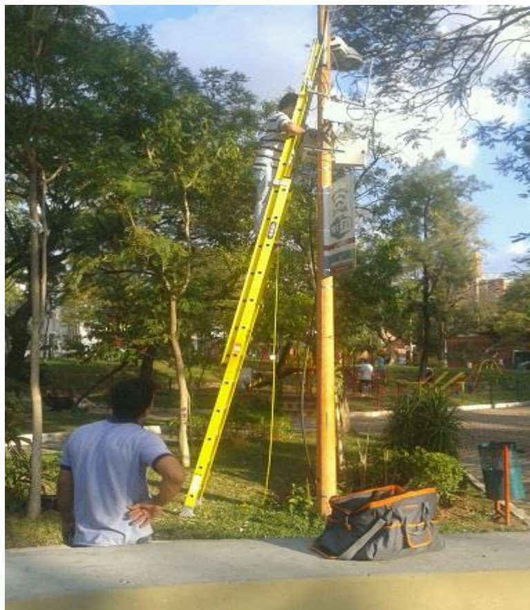
Instalación de wifi gratuito
