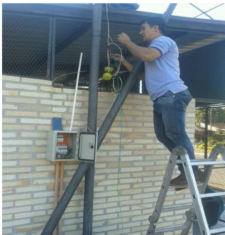
Instalación de wifi gratuito
